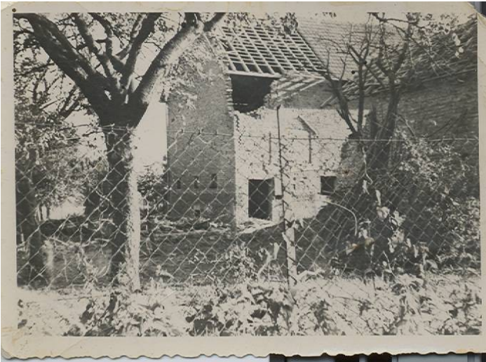
Zum Teil wurde das Dach abgedeckt.
